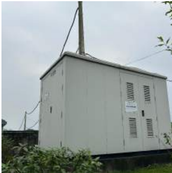
Hình 1.2. Trạm biến áp của cơ sở
