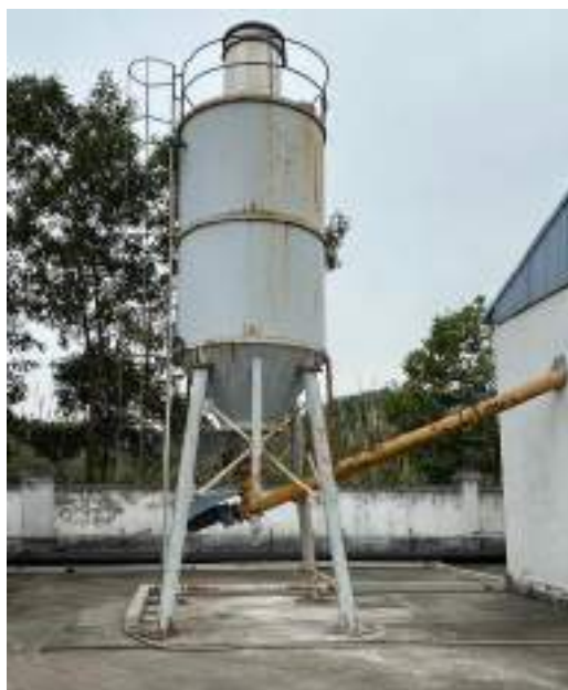
Hình 1.5. Hình ảnh silo vôi
